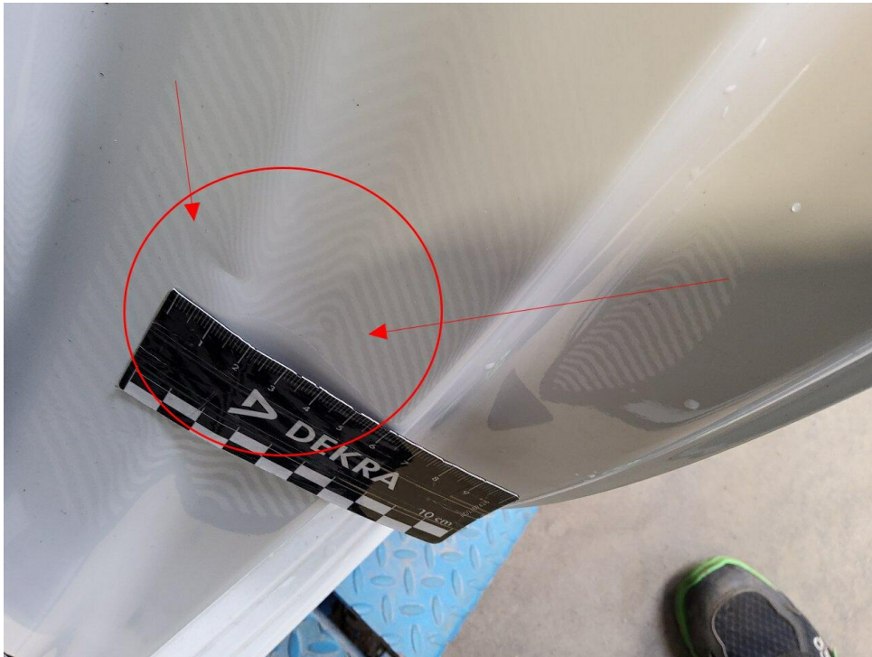
Bild 21 : Einstieg hinten links eingedellt
