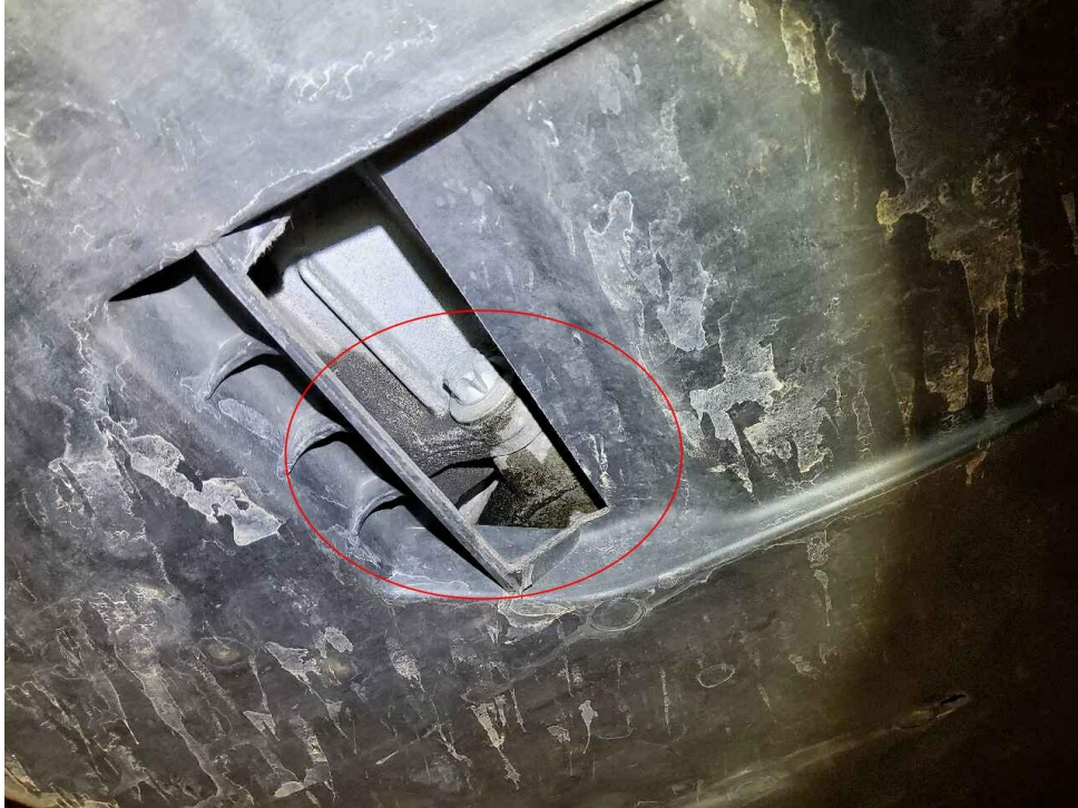
Bild 43 : Ölverlust, Motor Ölwanne KVA undicht
